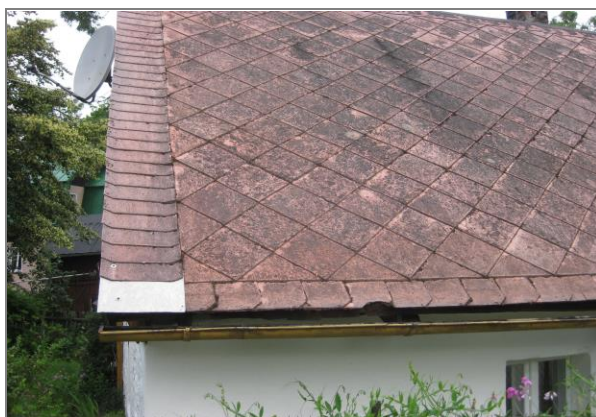
Fot. 2 Płyty azbestowo-cementowe płaskie
