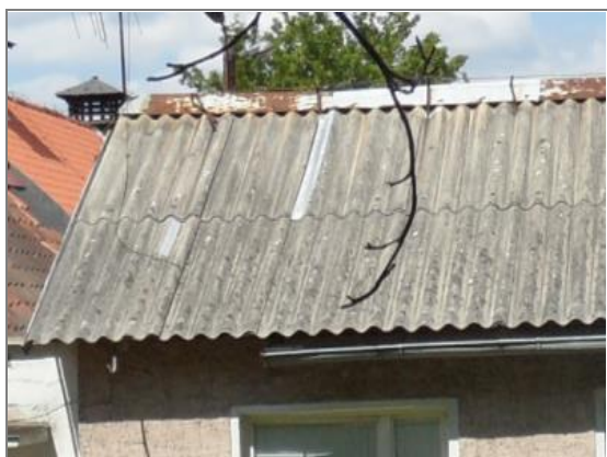
Fot. 1 Płyty azbestowo-cementowe faliste
